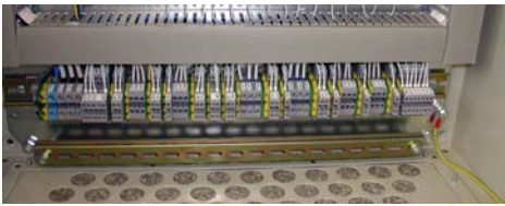
клеммник станции СУ-БТП-4NP
