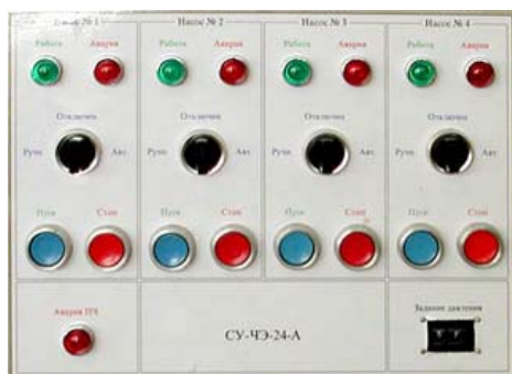
панель станции СУ-ЧЭ-24-А
